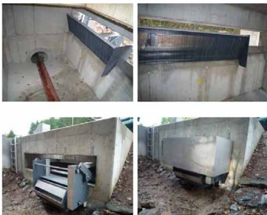
Fig 7 - Attrezzatura prevista in progetto a presidio degli sfioratori di piena (produttore: Giehl sewage engineering, Heimborn)
