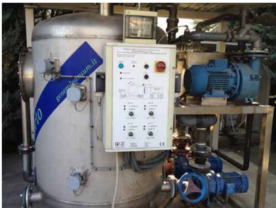
Fig. 4 - Centrale del vuoto della fognatura in depressione in cui si notano le pompe ad anello liquido del vuoto (alto a destra), serbatoio e pompe di invio reflui a fognatura (basso a destra)
