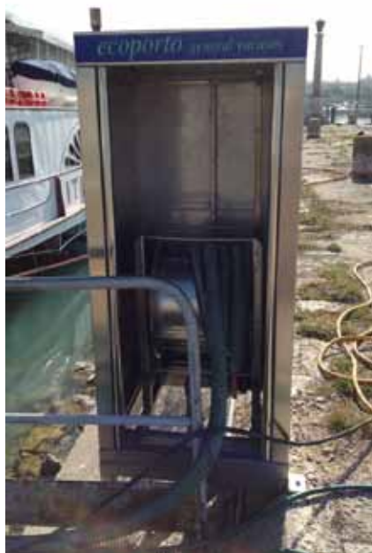
Fig. 3 - Colonna con tubazione di aspirazione della fognatura in depressione
