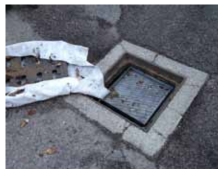
FIG. 6 caditoia stradale posta nel piazzale e dotata di sistema di captazione delle acque di lavorazione e sfioro delle acque meteoriche mediante tramoggia con luce di fondo tarata (da notare il pannello assorbente contro eventuali sversamenti, posto al di sotto della griglia, a "protezione" della caditoia)
