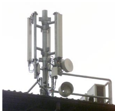
Un'antenna installata sul tetto di un edificio
