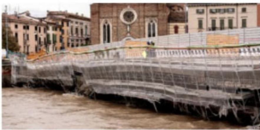
La piena. Ponte Navil messo a dura prova durante la piena dello scorso ottobre
