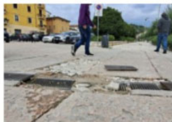
Frantumi La pavimentazione di piazza Isolo a pezzi
