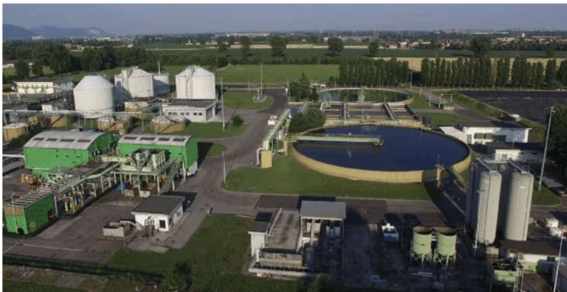
Depurazione Un grande impianto di depurazione. Sul tema delle acque reflue ieri si è svolto un incontro in Gran Guardia
